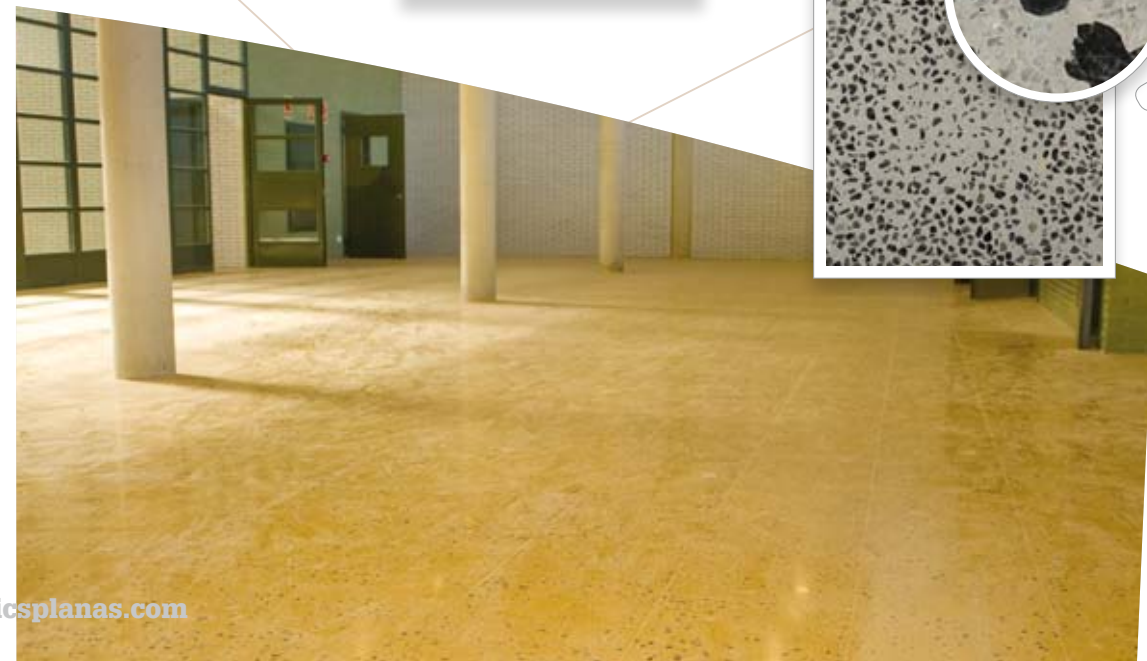
Centre penitenciari de Figueres (Girona) Centro penitenciario de Figueres (Girona) Ref. 629-8 40x40 cm 13.400 m 2
